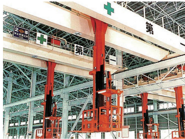
スタッカー式天井クレーン
